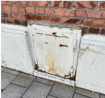
Figur 8. Kokslucka i gatunivå på befintlig byggnads fasad.
