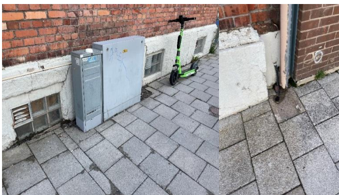
Figur 9. Elskåp (t.v.) samt huvudkabel (t.h.) vid befintlig byggnads fasad.
